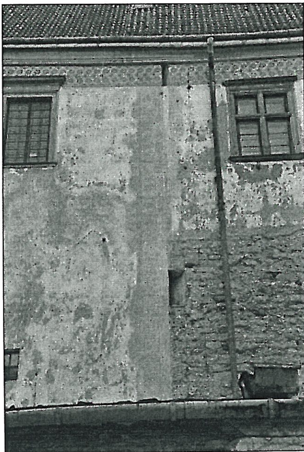
Fot.28 Szydłowiec, Zamek – elewacja północna. Fragment ściany z dekoracją bonii. Widoczna destrukcja tynków Stan zachowania przed konserwacją 04. 2010r. wyk. K. Mikołajek
