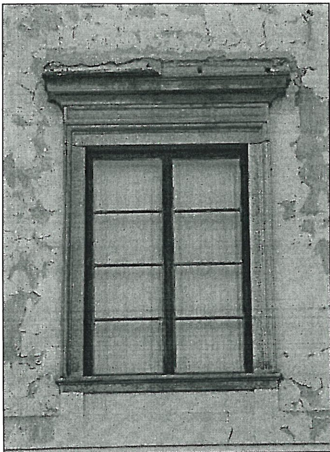
Fot.20 Szydłowiec, Zamek – elewacja wschodnia. Kamieniarka okienna z lat 70-tych. Widoczna zniszczona obróbka blacharska, destrukcja tynków Stan zachowania przed konserwacją 04. 2010r. wyk. K. Mikołajek
