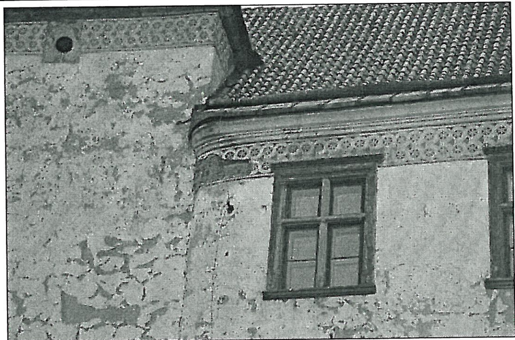
Fot.36 Szydłowiec, Zamek – elewacja wewnętrzna wschodnia. Fragment skrzydła zachodniego Stan zachowania przed konserwacją. Widoczna destrukcja tynków i dekoracji sgraffitowej. 04. 2010r. wyk. K. Mikołajek
