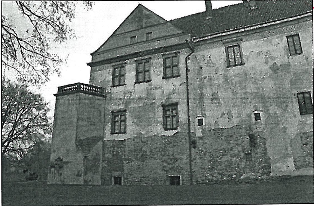
Fot.24 Szydłowiec, Zamek – elewacja północna. Fragment skrzydła północnego Stan zachowania przed konserwacją. Skute tynki w części cokołowej. 04. 2010r. wyk. K. Mikołajek
