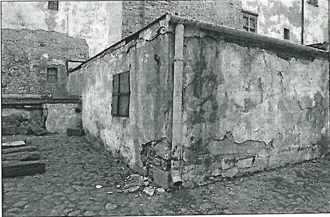
Fot.32 Szydłowiec, Zamek – elewacja północna. Narożny fragment przybudówki Stan zachowania przed konserwacją. Widoczna destrukcja tynków. 04. 2010r. wyk. K. Mikołajek
