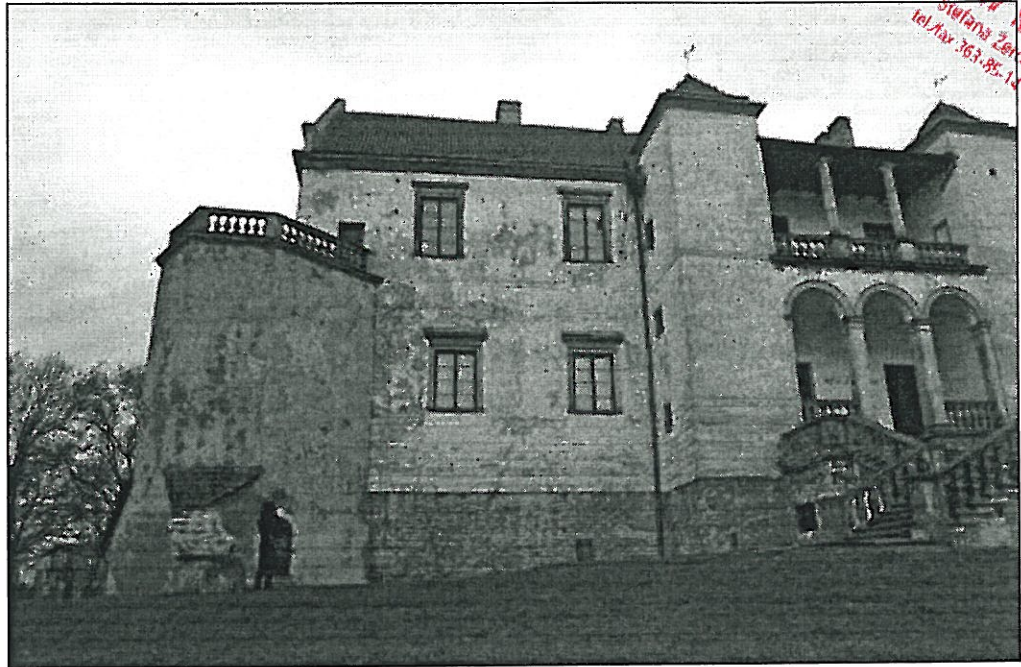
Fot.16 Szydłowiec, Zamek – elewacja wschodnia. Fragment skrzydła wschodniego Stan zachowania przed konserwacją. Widoczna destrukcja wyprawy tynkowej. 04. 2010r. wyk. K. Mikołajek
