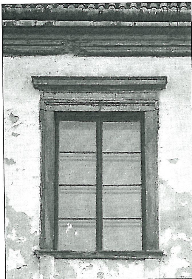
Fot.21 Szydłowiec, Zamek – elewacja wschodnia. Oryginalna kamieniarka okienna i kamienny gzyms. Widoczna destrukcja piaskowca. Stan zachowania przed konserwacją 04. 2010r. wyk. K. Mikołajek
