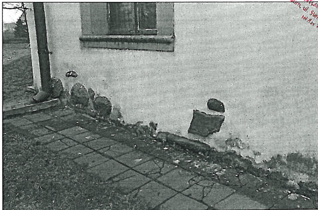
Fot.6 Szydłowiec, Zamek – elewacja zachodnia. Fragment cokołu, granitowe głązy . Stan zachowania przed konserwacją. Widoczne zawilgocenia, korozja biologiczna tynków. 04. 2010r. wyk. K. Mikołajek
