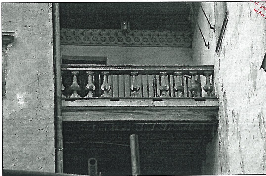
Fot.43 Szydłowiec, Zamek – elewacja wewnętrzna południowa. Fragment – balkon II piętra z drewnianą balustradą. Stan zachowania przed konserwacją. Widoczna destrukcja balustrady. 04. 2010r. wyk. K. Mikołajek
