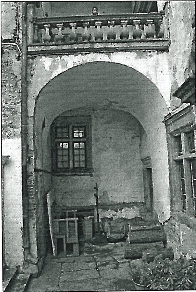
Fot.45 Szydłowiec, Zamek – elewacja wewnętrzna południowa. Fragment ściany z oryginalną kamieniarką okienną. Stan zachowania przed konserwacją. Widoczna destrukcja tynków. 04. 2010r. wyk. K. Mikołajek
