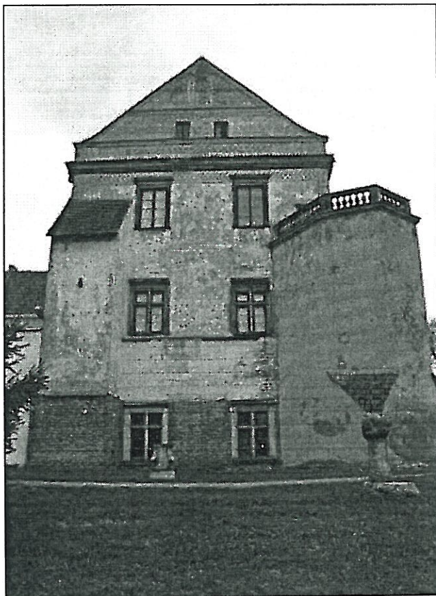
Fot.10 Szydłowiec, Zamek – elewacja południowa wschodniego skrzydła . Widok ogólny ścianę szczytową – widoczna destrukcja wyprawę tynkowej, sgraffita. W bardzo złym stanie także wyprawa tynkowa na ryzalicie. Stan zachowania przed konserwacją 04. 2010r. wyk. K. Mikołajek
