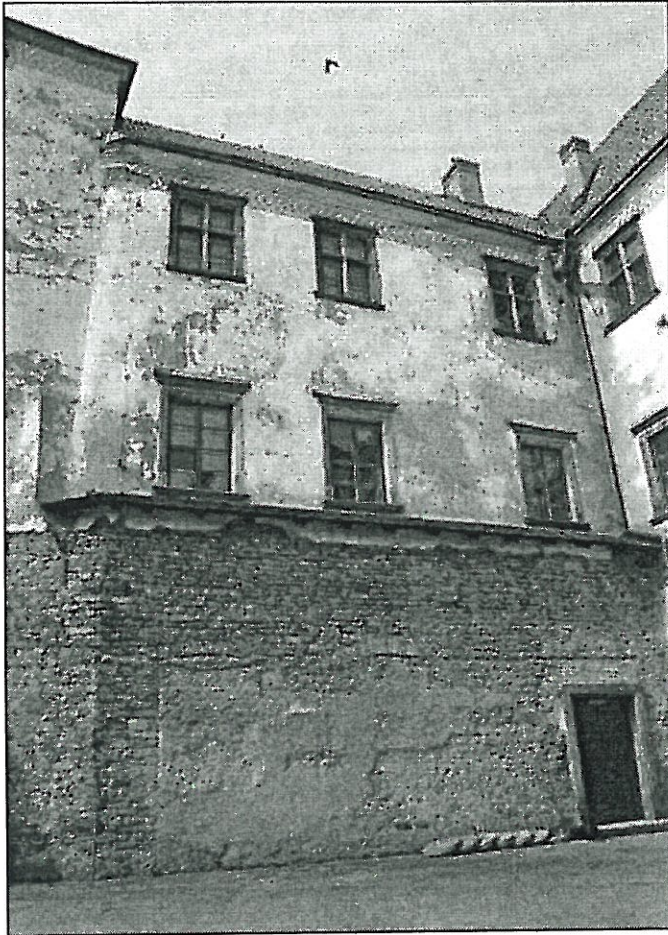
Fot.35 Szydłowiec, Zamek – elewacja wewnętrzna wschodnia. Stan zachowania przed konserwacją. Widoczna destrukcja tynków. 04. 2010r. wyk. K. Mikołajek
