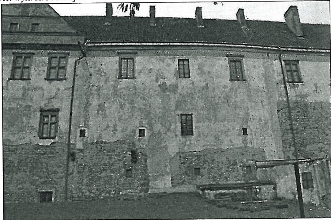
Fot.25 Szydłowiec, Zamek – elewacja północna. Środkowy fragment Stan zachowania przed konserwacją. Widoczne skute tynki, destrukcja zachowanej wyprawy tynkowej 04. 2010r. wyk. K. Mikołajek
