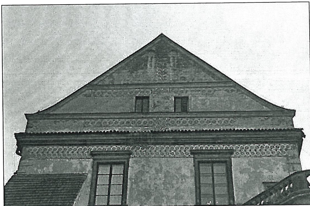
Fot.11 Szydłowiec, Zamek – elewacja południowa. Dekoracja sgraffitowa ściany szczytowej. Stan zachowania przed konserwacją. Widoczne znaczne ubytki sgraffita, destrukcja wyprawę tynkowej. 04. 2010r. wyk. K. Mikołajek
